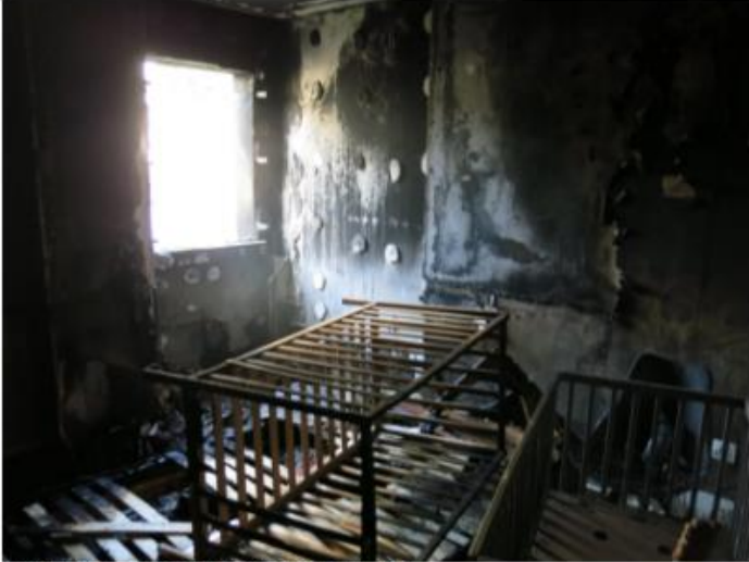
L'appartement de Vanessa Texier est entièrement détruit. (Photo NR Marie-Laure Aveline)
