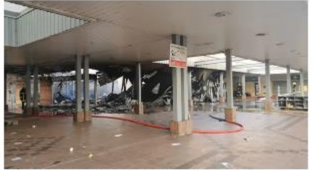
Des dégâts importants dans le centre commercial des Couronneries. © Radio France - Théo Caubet
